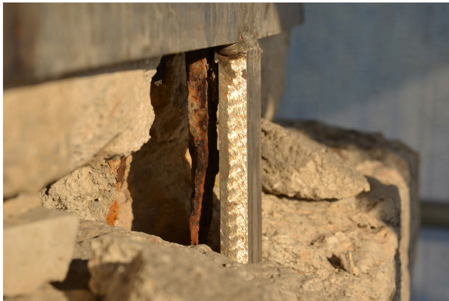
4 Podio della statua. La cerchiatura metallica esterna in acciaio inossidabile è stata saldata agli elementi metallici decoesi, accelerando il fenomeno di ossidazione.
