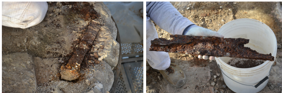
6 Fenomeni di ossidazione degli elementi di collegamenti interni tra i blocchi che definiscono i rocchi del capitello.
