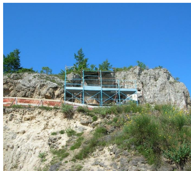
Fig. 2 Grotta Reali (Rocchetta a Volturno, Isernia). L'area dello scavo con l'impalcatura realizzata per accedere ai livelli musteriani (foto A. Priston).
