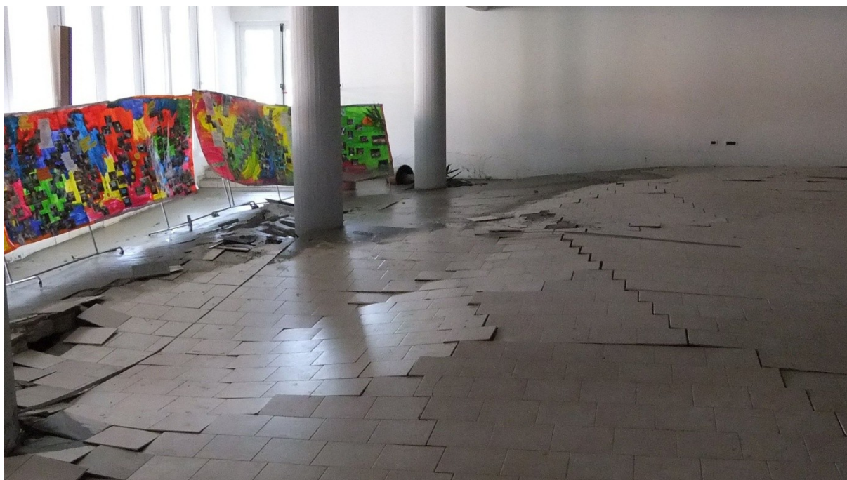
Figura 2.36 - Sollevamento del solaio a terra e della pavimentazione dell'oratorio della chiesa a San Carlo.
