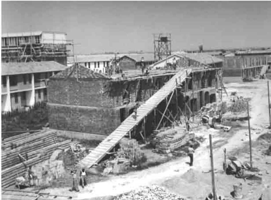
65 Immagine d'archivio che ritrae l'attività e le attrezzature in un cantiere edile nel periodo di attività della Gestione INA Casa.
