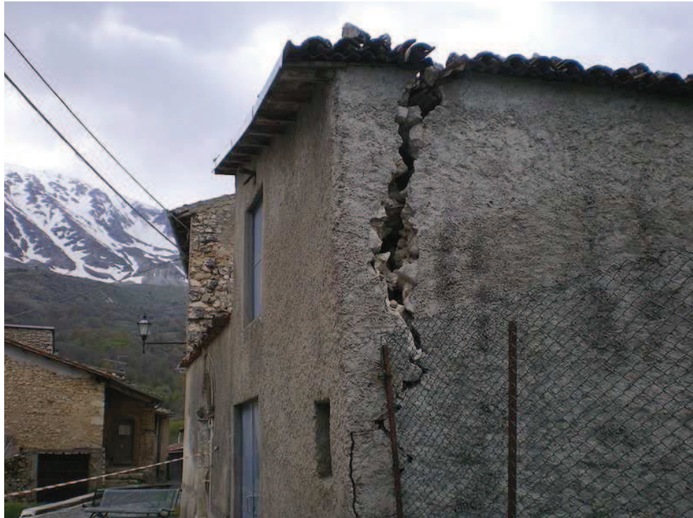
Figura 1.5 Edificio lesionato a San Martino d'Ocre.
