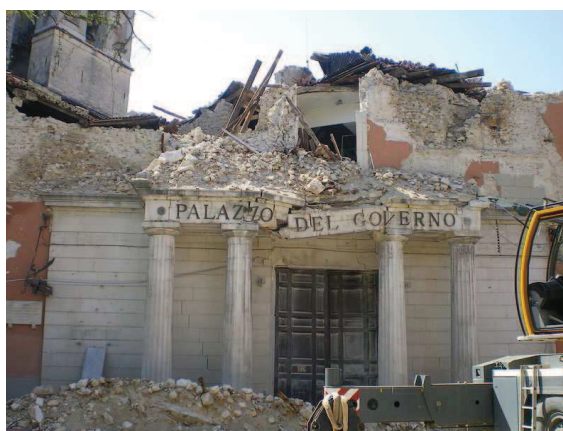
Figura 1.4 _La Prefettura dell'Aquila dopo il sisma.
