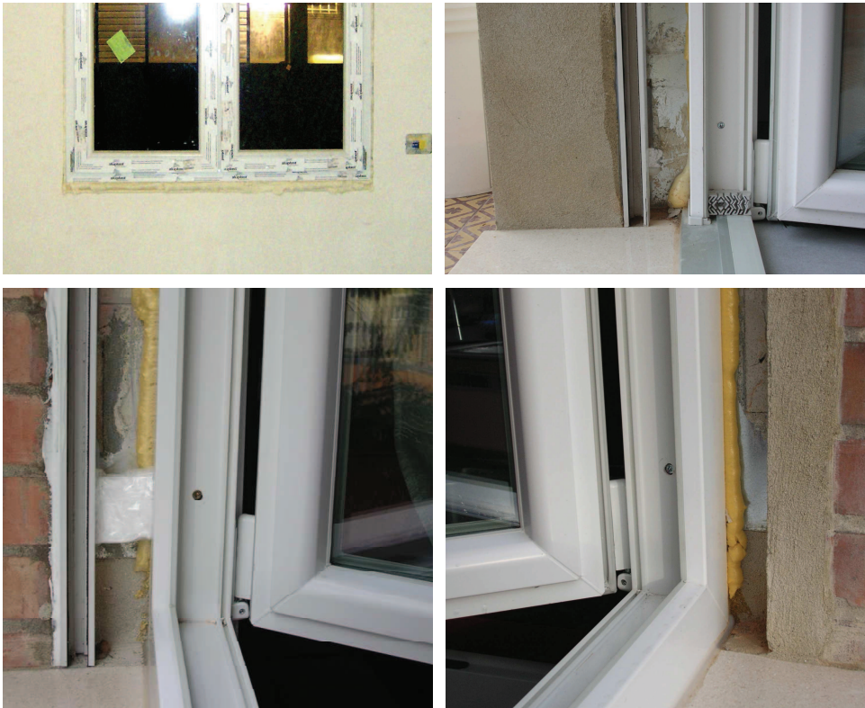
Figure 6.6, 6.7, 6.8 e 6.9 Posa in opera degli infissi: come si vede dalle immagini, in questo caso si è proceduto con il taglio del ponte termico ed acustico del davanzale e del controtelaio, riempiendo poi i vuoti intorno al telaio fisso con un listello in legno e della schiuma poliuretanic per sigillare.
