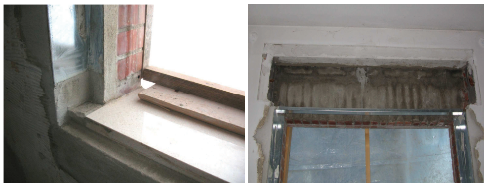
Figura 6.3 Due criticità: il rapporto con la cortina muraria ed il posizionamento dei sistemi oscuranti.
