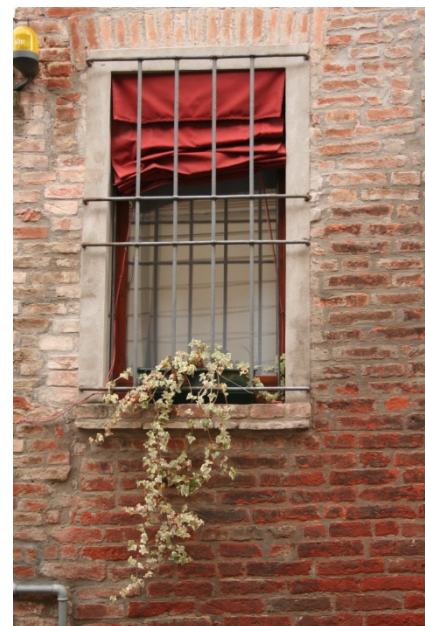
Esempio di alterazione del serramento con realizzazione di anta unica a tutta ampiezza.
