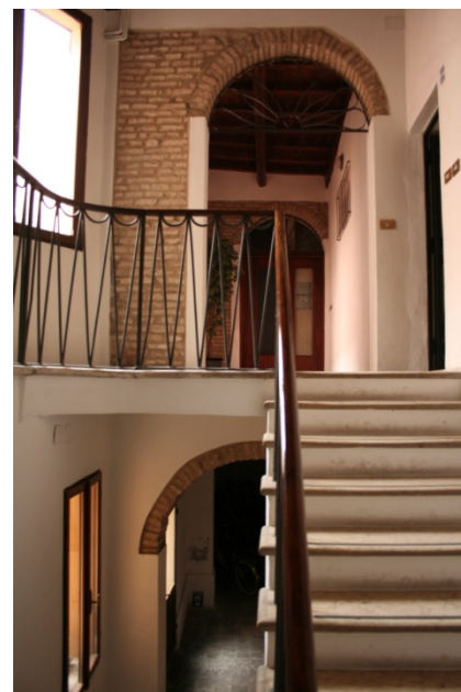
Corpo scala completamente aperto sull'androne, in basso, e su un disimpegno, in alto.
