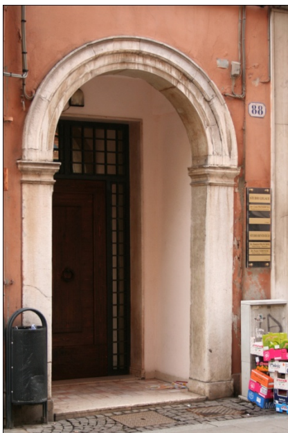
Due esempi di errata trasformazione di una porta nel corso di un intervento recente. In alto, arretramento del portone, rispetto al foro del portale, con aumento della superficie disperdente e alterazione della composizione di facciata. In basso, inserimento di serramento vetrato, in luogo di precedente serramento ligneo.
