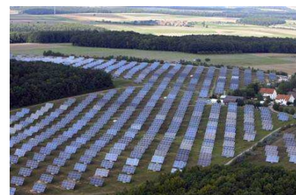
Impianto a terra di produzione elettrica da pannelli fotovoltaici in aperta campagna.
