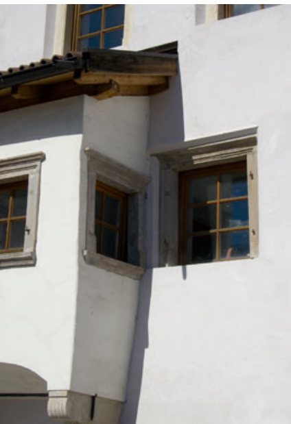
Inserimento di cappotto esterno su edificio storico, si osservi l'incassamento degli elementi decorativi delle finestre.
