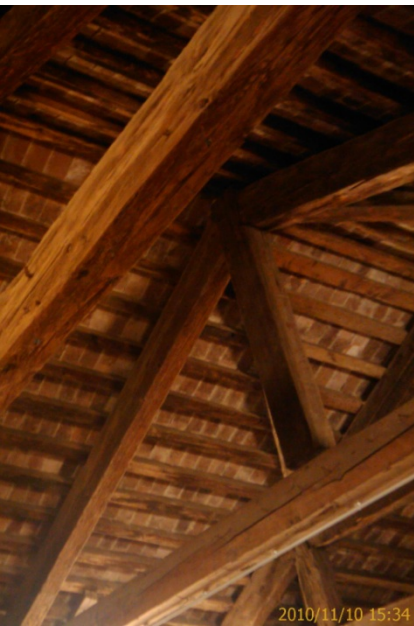
Sopra e sotto, esempi di copertura ferrarese con capriate e travi in appoggio non spingente.
