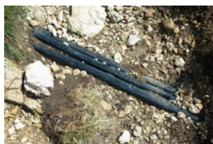
Illustrazione 4 | Tubi di apporto d'acqua dalle vasche di accumulo al rifugio. Nel caso di volontà di estensione del periodo di apertura del rifugio, sarà opportuno verificare le interazioni climatiche (nel caso specifico le implicazioni legate alla temperatura).
