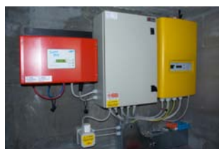
Illustrazione 7 | Inverter e integrazioni impiantistiche utili al collegamento dell'impianto fotovoltaico al parco batterie per l'accumulo dell'energia prodotta.
