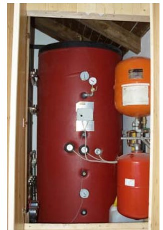
Illustrazione 1 | Accumulatore di acqua riscaldata dal calore recuperato dal funzionamento del cogeneratore in esercizio. In caso di superamento della temperatura impostata, l'acqua calda è utilizzata per alimentare il pavimento radiante realizzato nei locali interni del rifugio. Nella foto: accumulatore installato presso il rifugio Roda di Vaél, gruppo del Catinaccio (TN), 2280 m, SAT.
