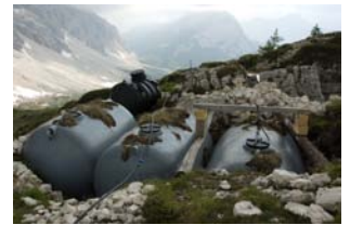
Illustrazione 24 | Cisterne per l'accumulo dell'acqua: è una risorsa indispensabile nella conduzione di un rifugio alpino (e delle attività ricettive in generale). Non sempre è possibile assicurare la fornitura continua e sono in genere utilizzati dei sistemi di approvvigionamento. Nella foto: cisterne d'accumulo di acqua proveniente da nevai (alimentate sfruttando il principio dei vasi comunicanti) e non potabile; installate presso il rifugio Tissi, Col Rean-Civetta (BL), 2250 m, CAI Belluno.
