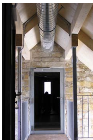
Illustrazione 60 | Dettaglio dell'elemento di collegamento tra la parte nuova e quella esistente dell'edificio. Sono visibili in alto anche gli elementi di integrazione impiantistica.
