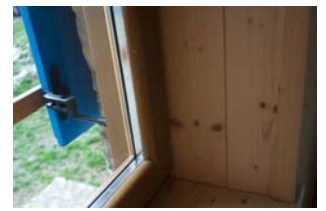
Illustrazione 20 | L'utilizzo di infissi a tenuta all'aria dotati di vetrocamera permette di ridurre le dispersioni di calore. Nella foto: infisso installato durante i lavori per la riqualificazione del rifugio Roda di Vaél, gruppo del Catinaccio (TN), 2280 m, SAT.
