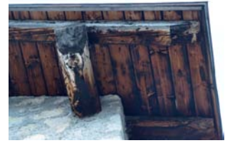
Illustrazione 2 | Dettaglio della muratura in pietra e della copertura in legno del rifugio. In entrambi i casi, i sistemi di chiusura non sono dotati di isolamento termico (condizione verificabile nella maggior parte dei rifugi alpini). Nella foto: rifugio Vandelli, Sorapìss (BL), 1928 m, CAI Venezia.
