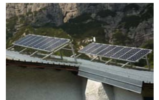
Illustrazione 39 | Impianto fotovoltaico installato sulla copertura del rifugio. Pur non assicurando piena autonomia energetica, con il supporto delle batterie consente la conduzione del rifugio per molte ore (lontano dai carichi di punta) senza il ricorso all'accensione del generatore.
