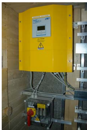
Illustrazione 3 | Dispositivo inverter collegato all'impianto fotovoltaico necessario a consentire l'interazione tra l'energia elettrica prodotta dall'impianto fotovoltaico e la ricarica delle batterie che consentono un utilizzo differito dell'energia prodotta.
