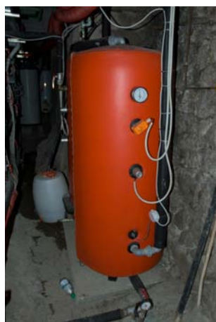
Illustrazione 36 | Boiler per l'accumulo dell'acqua calda prodotta. Può essere integrato al riscaldamento proveniente da più fonti di generazione. Nella foto: il boiler del rifugio Papa, Monte Pasubio (VI), 1929 m, CAI Schio (VI)
