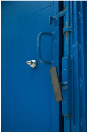
Illustrazione 22 | Sistema di chiusura invernale degli infissi esterni (sono visibili i bulloni fissabili dall'interno). Nella foto: installazione nel rifugio VII Alpini alla Schiara, Belluno, 1503 m, CAI Belluno.
