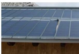
Illustrazione 3 | Sono visibili dei danneggiamenti generati in periodo invernale dall'azione del carico della neve. Sono frequenti le problematiche legate alla manutenzione degli impianti installati in quota. Nella foto: copertura con pannelli fotovoltaici installata presso il rifugio Volpi al Mulaz (BL), 2560 m, CAI Venezia.
