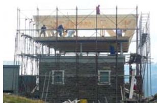
Illustrazione 48 | Fasi di lavorazione durante il processo di riqualificazione del rifugio: realizzazione della zona notte in legno, al di sopra della sala panoramica.
