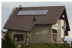
Illustrazione 2 | Impianto fotovoltaico installato sulla falda della copertura di un rifugio alpino.
