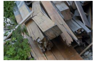
Illustrazione 6 | Travi spezzate dal carico nevoso accumulatosi durante la stagione invernale. Nella foto, i travi sono accatastati a terra dopo la loro sostituzione presso il rifugio Berti al Popera (BL), 1950 m, CAI Padova).
