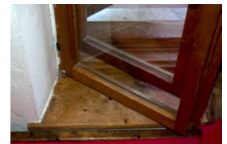
Illustrazione 21 | Il raddoppio dell'infisso permette di realizzare una rudimentale camera d'aria e di ridurre le dispersioni termiche. Nella foto: doppio infisso installato al rifugio Tissi, Col Rean-Civetta (BL), 2250 m, CAI Belluno.
