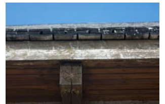
Illustrazione 14 | Copertura realizzata con scandole in legno posate su listellatura o tavolato in legno. Non sono in genere utilizzate in aggiunta guaine impermeabilizzanti. Nella foto: copertura del rifugio Sonino al Coldai (BL), 2132 m, CAI Venezia.
