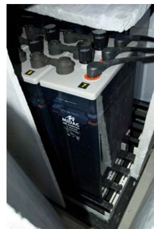
Illustrazione 10 | Batterie dotate di coibentazione per impedire bruschi cali di carica dovuti agli sbalzi termici. Nella foto: batterie installate al rifugio Pradidali, Pale di San Martino (TN), 2278 m, CAI Treviso.
