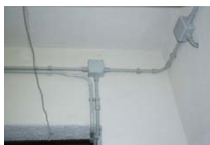
Illustrazione 17 | Nel caso di integrazioni impiantistiche i cablaggi e i cavi vengono passati di solito esternamente o in appoggio alla muratura. Nella foto: cablaggi realizzati al rifugio VII Alpini sulla Schiara, Belluno, 1502 m, CAI Belluno.
