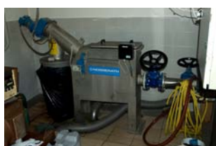
Illustrazione 32 | Sistema di separazione dei reflui tramite grigliatura. La parte solida è separata dai liquidi per essere raccolta e stoccata in appositi contenitori che verranno poi trasportati e smaltiti a valle. Nella foto: l'impianto in funzione presso il rifugio Roda di Vaél, gruppo del Catinaccio (TN), 2280 m, SAT.
