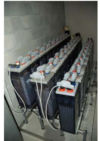
Illustrazione 42 | Batteria di accumulo dell'energia elettrica prodotta dal fotovoltaico. In genere gli impianti sono integrati con il generatore che carica ulteriormente le batterie durante il suo funzionamento. Il contributo delle batterie consente di tenere operativo il rifugio nei periodi in cui il generatore è spento (lontano dai carichi di punta). Nella foto: le batterie installate presso il rifugio Volpi al Mulaz (BL), 2560 m, CAI Venezia.
