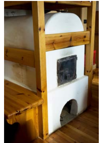
Illustrazione 23 | Esempio di "stube", stufa massiva a legna in grado di sfruttare l'inerzia termica della pietra per poi riscaldare tutto l'ambiente attraverso lo scambio radiante. Nella foto: la stufa in funzione al rifugio Roda di Vaél, gruppo del Catinaccio (TN), 2280 m, SAT.
