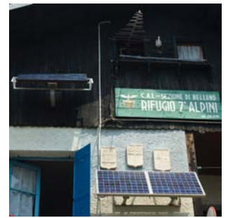
Illustrazione 16 | Impianti connessi al funzionamento dei sistemi di telecomunicazione. Nella foto: rifugio VII Alpini, 1500 m, CAI Belluno.
