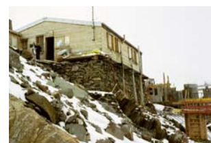
Illustrazione 67 | Nell'immagine d'archivio, è visibile in primo piano il vecchio rifugio. Alle spalle è osservabile il cantiere della nuova struttura: una volta ultimata, si è proceduto alla demolizione del primo.
