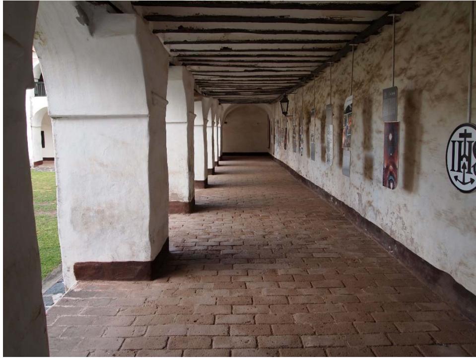
Ilustración 91 Crujía con la actual imagen de galería (Foto Arq. Pedro David Cufre)
