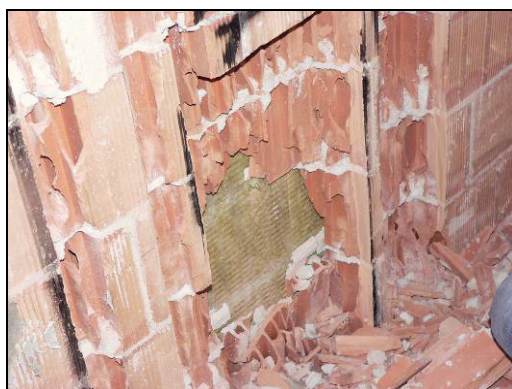
Figura 16: esempio di uno scasso troppo profondo in una parete doppia per l'installazione di un impianto tecnico
