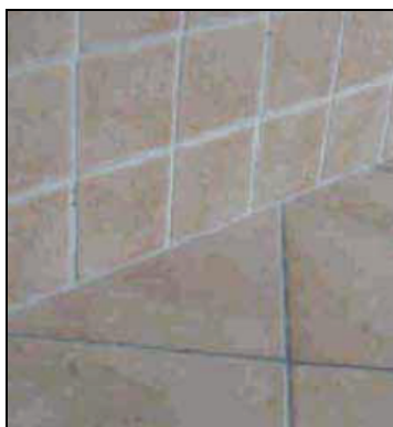
Figura 85: esempio di posa errata del rivestimento a parete a contatto diretto con la pavimentazione
