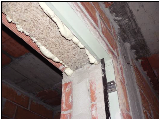
Figura 31: esempio di corretta posa di materiale a riempimento dell'intercapedine tra telaio fisso e architrave, con sigillatura tra le fessure
