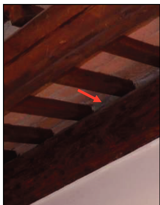
Figura 27: particolare del giunto tra parete e tetto con indicazione del ponte acustico (prima dell'intervento)
