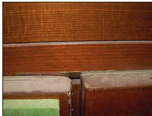
Figura 39: particolare della fessura presente in corrispondenza del meccanismo di chiusura alto centrale
