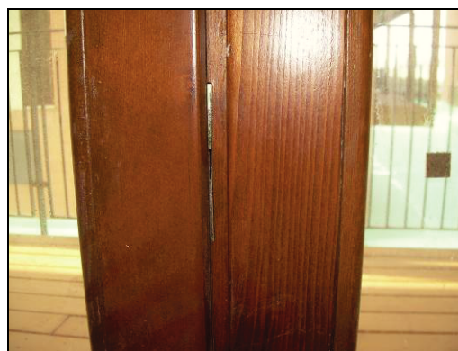
Figura 41: particolare della fessura presente in corrispondenza meccanismo di chiusura centrale ad ante chiuse
