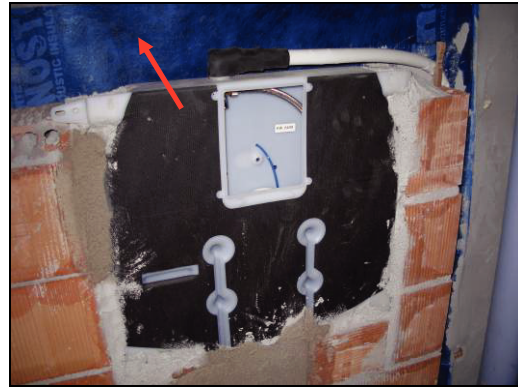
Figura 119: esempio di cassetta opportunamente svincolata dalla parete divisoria tramite materiale antivibrante
