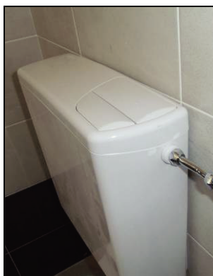
Figura 116: esempio di cassetta del WC fissata rigidamente alla parete (errore di posa)
