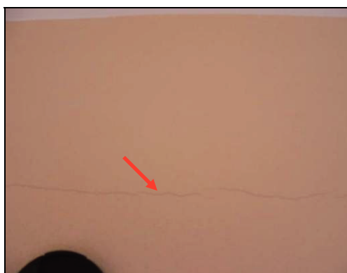
Figura 19: esempio di fessurazione in prossimità del giunto parete – soffitto
