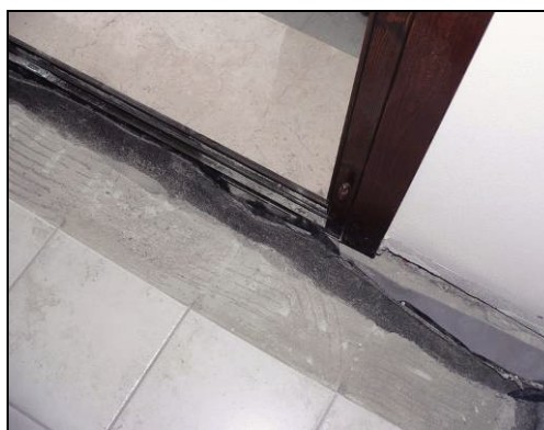
Figura 81: particolare della soglia della portafinestra con indicazione del materiale troppo corto e quindi non correttamente risvoltato
