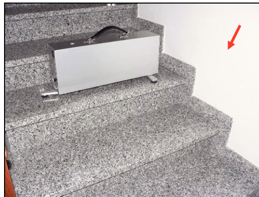
Figura 60: vista del vano scala della misura B con indicazione della parete divisoria, connessa rigidamente al vano scala stesso
