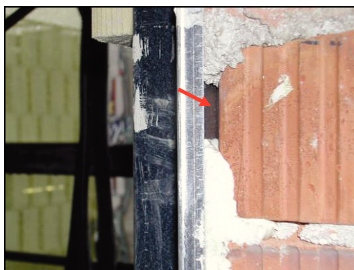
Figura 45: particolare del riempimento parziale dell'intercapedine tra un controtelaio metallico e la parete esterna
