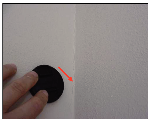
Figura 20: esempio di fessurazione in prossimità del giunto parete – parete
