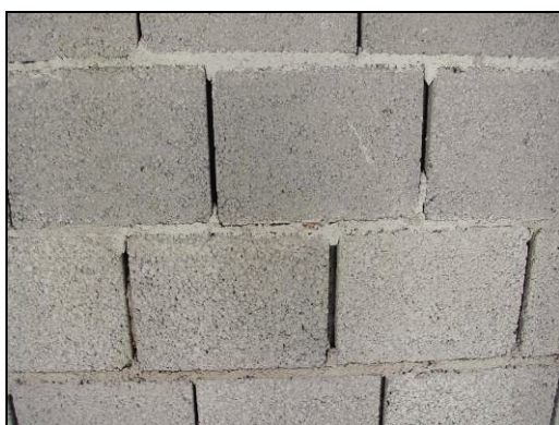
Figura 9: esempio di assenza totale della malta nei giunti verticali per un parete monostrato
