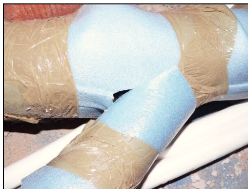
Figura 112: altro esempio di lacerazione del rivestimento della tubazione
