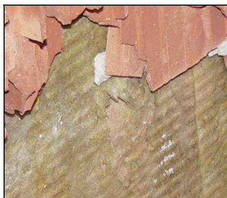
Figura 17: particolare della lacerazione parziale del materiale fonoassorbente interno all'intercapedine della parete doppia
