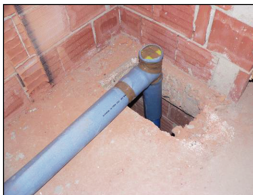
Figura 105: esempio di colonna di scarico (e diramazione) rivestita correttamente con materiale fonoisolante nel punto di attraversamento del solaio
