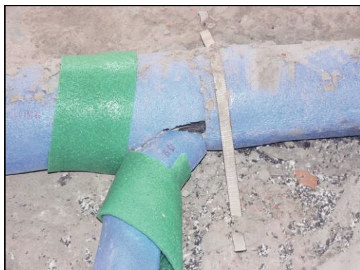
Figura 111: esempio di lacerazione del rivestimento della tubazione
