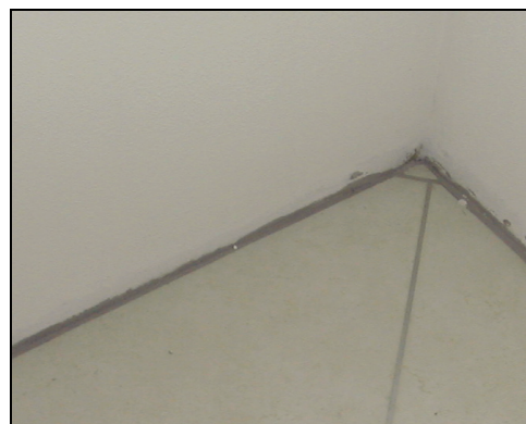
Figura 84: particolare giunto tra mattonelle in ceramica e parete riempito con sigillante rigido (errore di posa)
