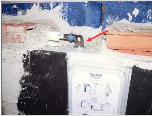
Figura 121: esempio di valvola di adduzione (di una cassetta incassata) in cui è assente il rivestimento
