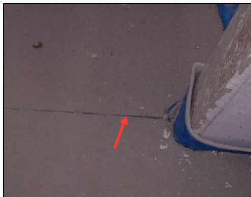
Figura 72: esempio di errore di posa, separazione strutturale eseguita ma senza la posa del giunto di separazione
