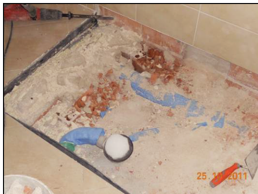
Figura 113: esempio di errata posa in opera nella zona del piatto doccia, con il materiale anticalpestio assente
