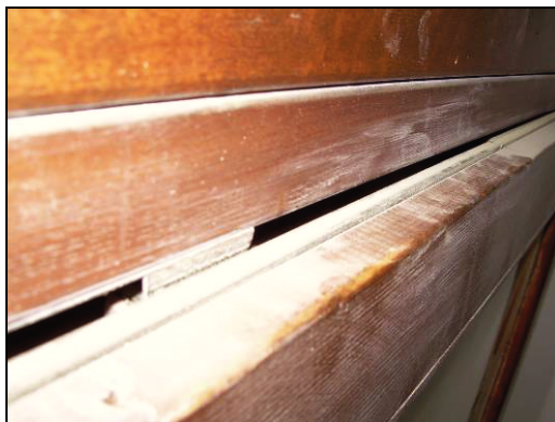
Figura 38: particolare della fessura presente tra le ante e la battuta nella parte superiore della portafinestra
