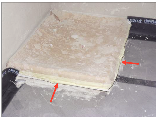
Figura 70: esempio di assenza della fascia perimetrale sul perimetro del piatto doccia
