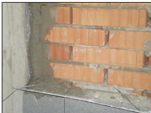
Figura 11: esempio di assenza della malta nei giunti verticali per una parete di mattoni pieni
