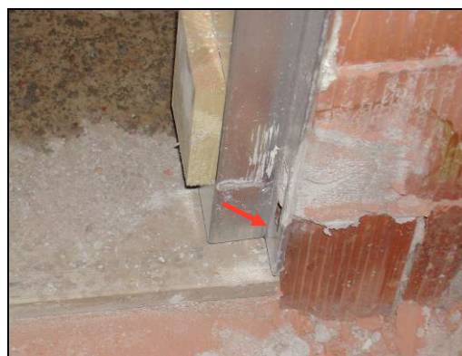
Figura 46: particolare di un'altra zona in cui la malta è assente
