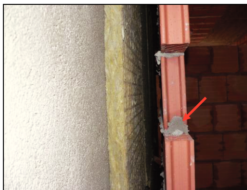
Figura 24: esempio di residui di malta che ostacolano la sistemazione corretta dei blocchi ad incastro
