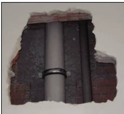
Figura 102: esempio di cavedio integrato alla parete di massa insufficiente (blocchi forati da 8 cm), senza rivestimento interno e con la tubazione non rivestita
