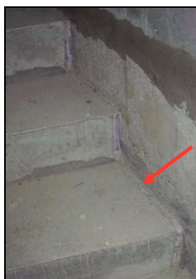
Figura 57: esempio di errore progettuale – scala connessa rigidamente alla parete divisoria
