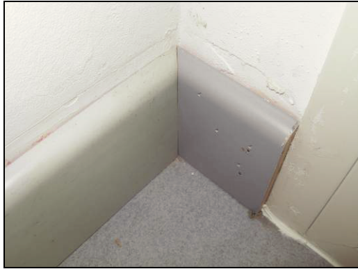
Figura 88: esempio di errata posa del battiscopa a diretto contatto con la pavimentazione
