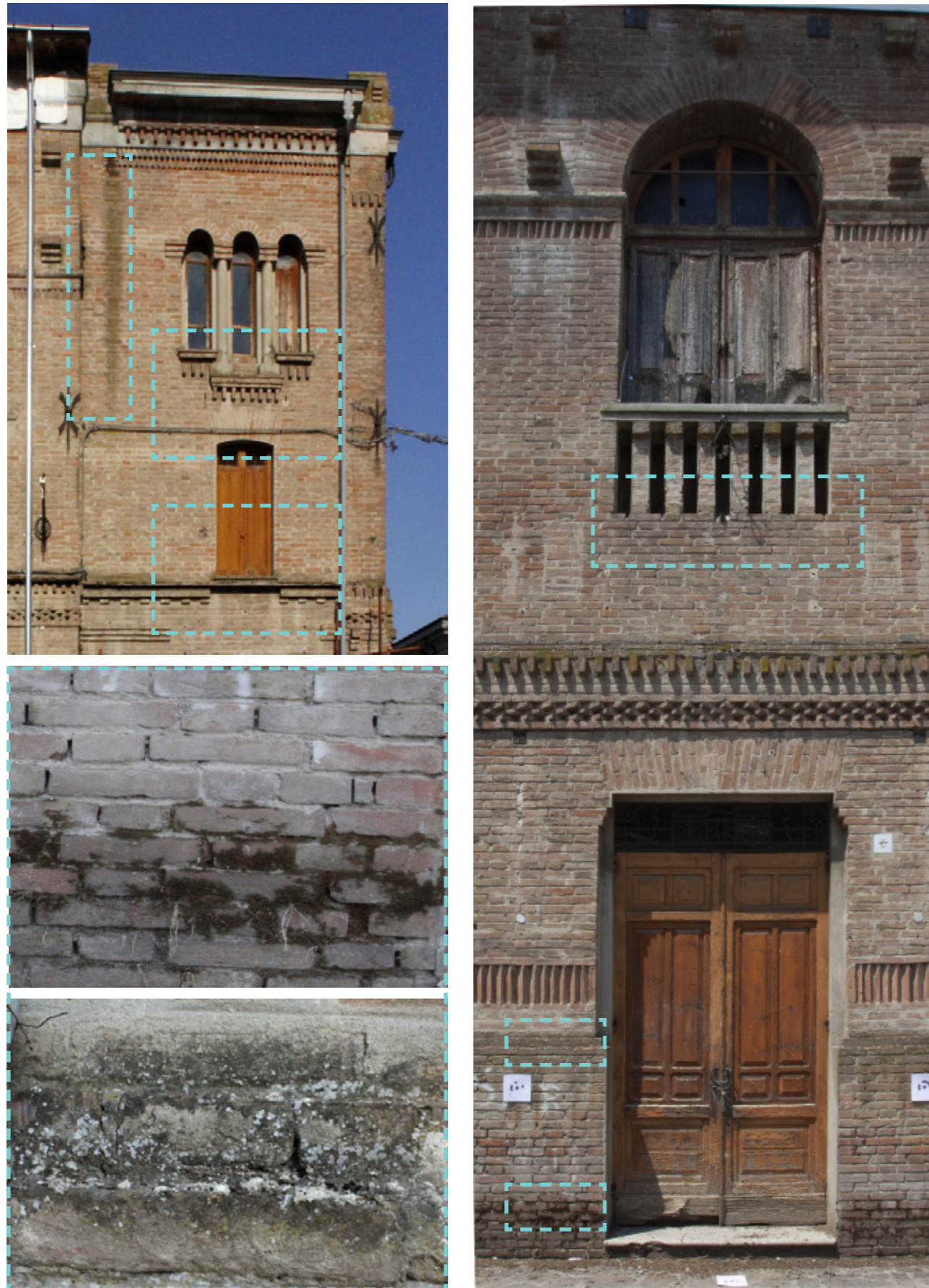
Fig. 103 Degradation morphologies of the external surfaces_East side of Viale Martiri della Libertà. Developed by M. Suppa
