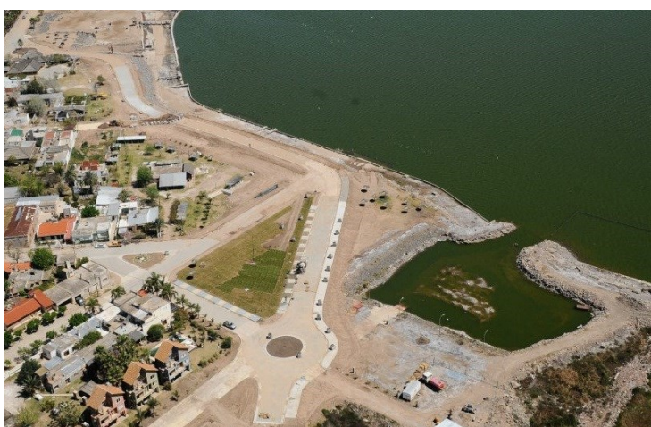
Imagen 17. Vista aérea de la primer fase de la construcción de la defensa-costanera, año 2013. Fuente: Perfil de Facebook de la Municipalidad de Miramar (Consultado diciembre 2015).
